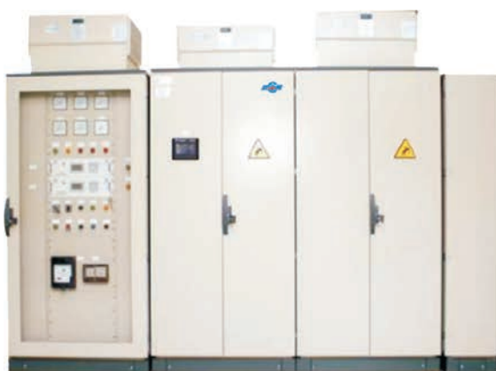
Статические системы возбуждения турбо- и гидрогенераторов с током возбуждения не более 3600А
